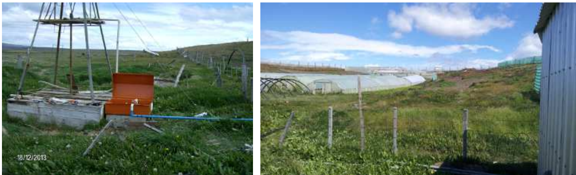
Figura 2 – Bomba fotovoltaica (izq), y cañería hacia tanque elevado sobre los invernaderos
