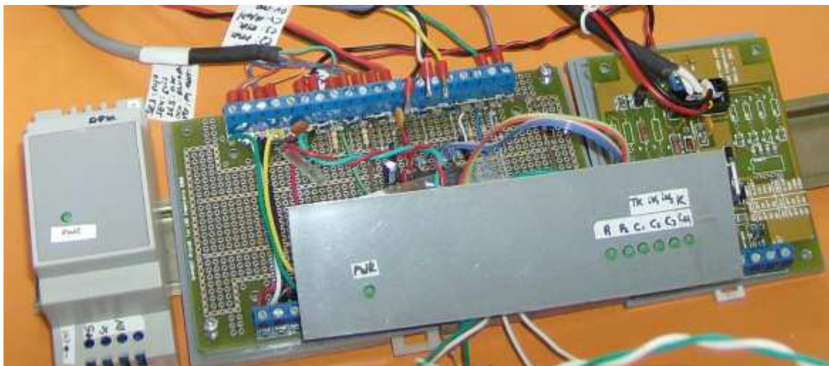
Figura 10 (izq) Módulo F2V, (centro) Acondicionamiento señales R840, (der) placa VIN-IAE
