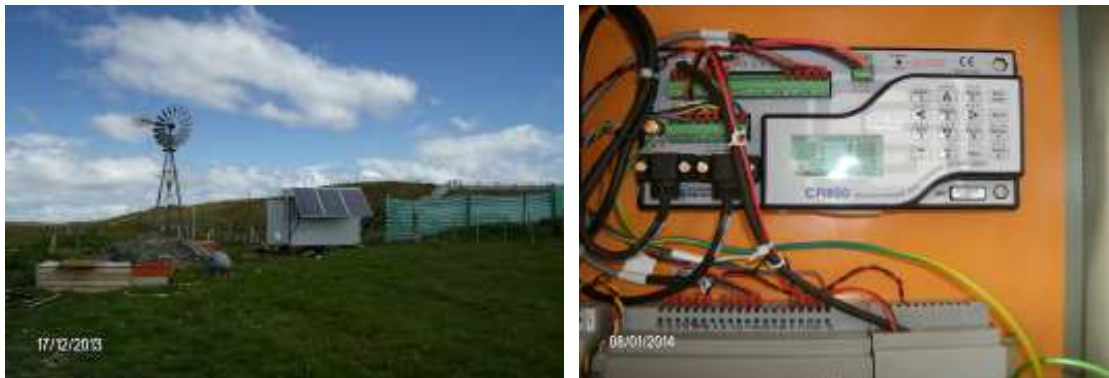
Figura 3 – Refugio con paneles instalados (izq), y sistema de control y registro con CR850
