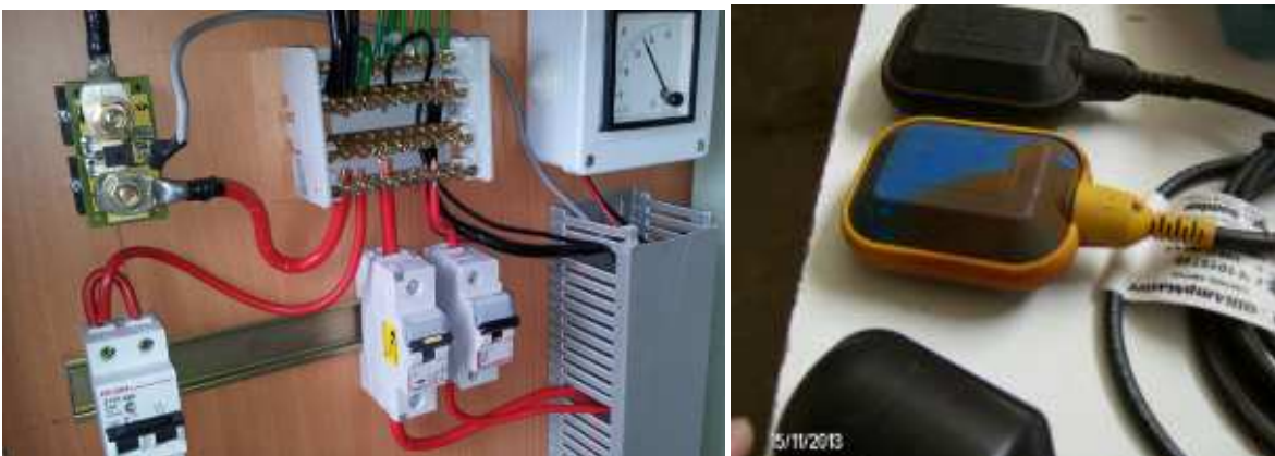
Figura 13 (izq) Placa para ACS752 con ACS758(50A), y flotantes utilizados en la primera instalación
